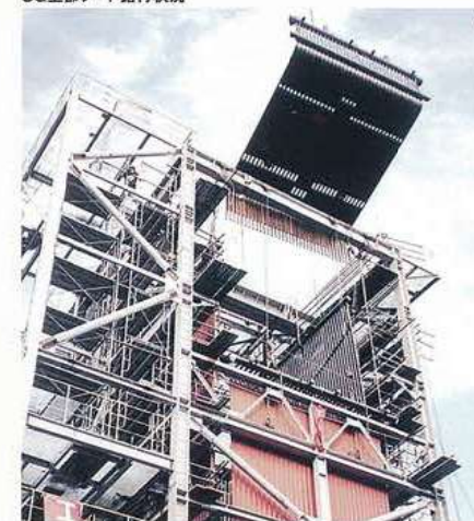
CDQボイラー(コークス乾式消火設備)据付工事 Erection work for the CDQ (Coke Dry Quench) boiler
