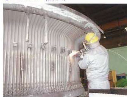
OGフード 外面ワイヤ溶射施工 Wire spraying outer surface of the OG hood
