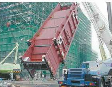
ボイラー据付工事ブロック化パネル上架 Installation of pre-assembled water wall panels
